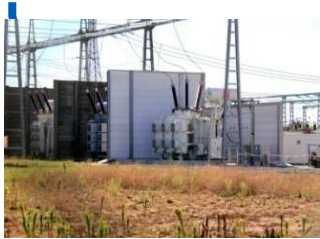
Métiers du réseau Smart grids
